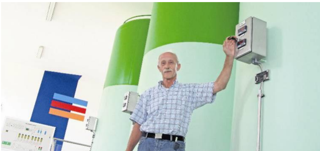
Wenn's um das Greven Wasserwerk geht, ist er der Mann, der wirklich alles weiß: Manfred Walterskötter steht hier vor den riesigen Filteranlagen.
