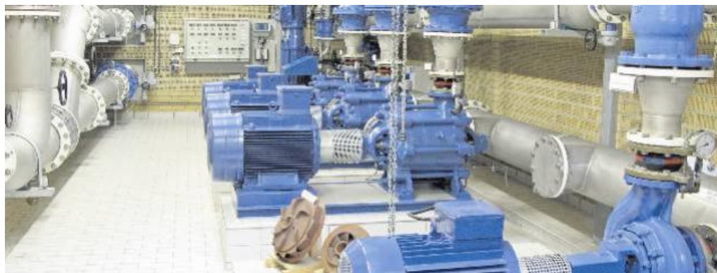
Rohre, Pumpen, ein bisschen Krach: Viel Technik ist nötig, um das Wasser in die Haushalte zu bekommen. Hier der Technikraum des Wasserwerkes. GZ-Foto Henrichmann
